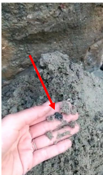
Figura 28 - Presença de brita 0 misturada a areia no interior da estaca
