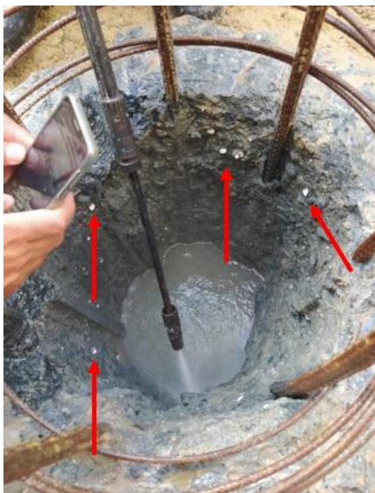
Figura 29 - Estaca Hélice Contínua com anomalias e presença de conchas marinhas
