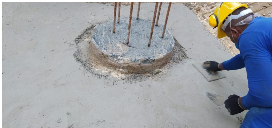
Figura 23 – Concreto "magro" com separação da estaca
